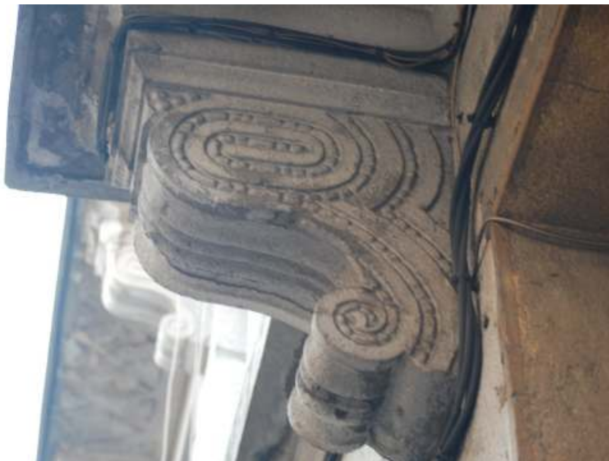
Dans la rue, vue de dessous d'un balcon, rue de la Paix à St-Etienne
